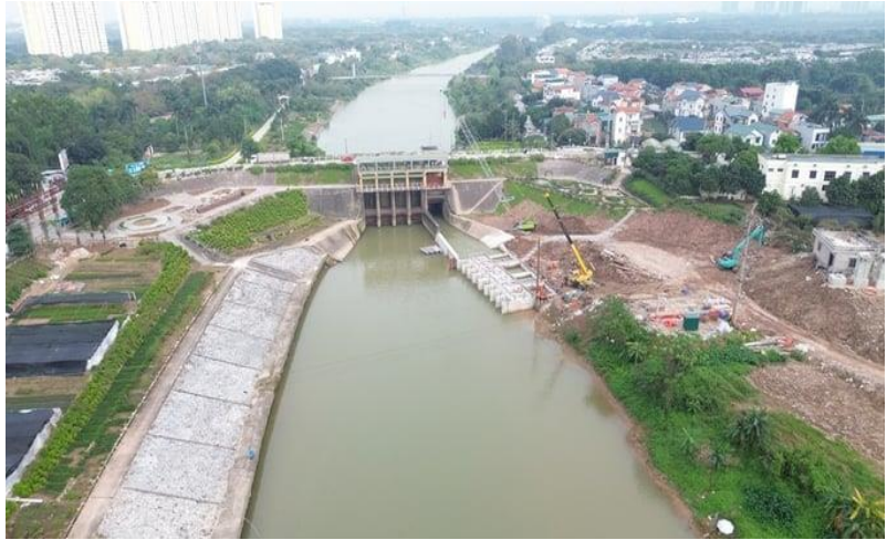
Cống Xuân Quan - công trình đầu mối hệ thống thủy lợi Bắc Hưng Hải lấy nước từ sông Hồng.
